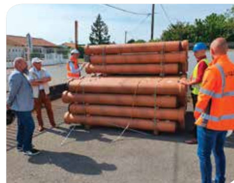
Canalisations en grès.
